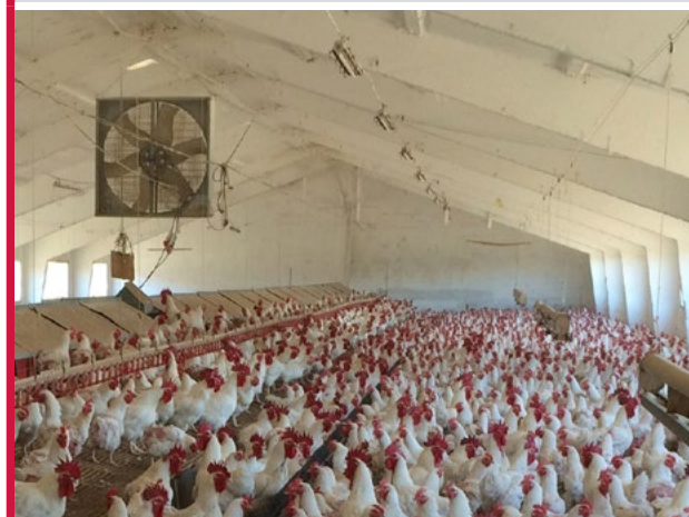
Рисунок 96 Вентиляторы циркуляции в птичнике открытого типа/с естественной вентиляцией.
