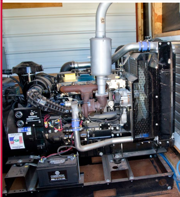
Рисунок 93 Пример запасного генератора.
