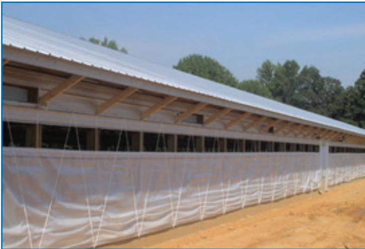
Figura 3: Esempio di tetto bianco per ridurre il carico di calore nel capannone.
