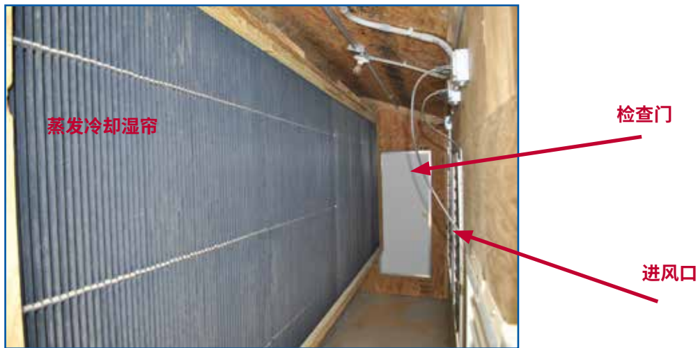
图 6.20: 鸡舍侧墙上安装在侧室中的湿帘示例。
