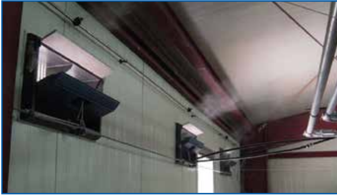
图 6.21：横向通风的鸡舍所使用的喷雾系统示例。
